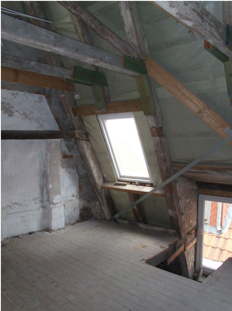
ungenehmigter Eingriff in die Kehlbalkenlage © LAKD M-V/LD
